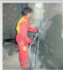
مقاوم سازی ساختمان های فرسوده
